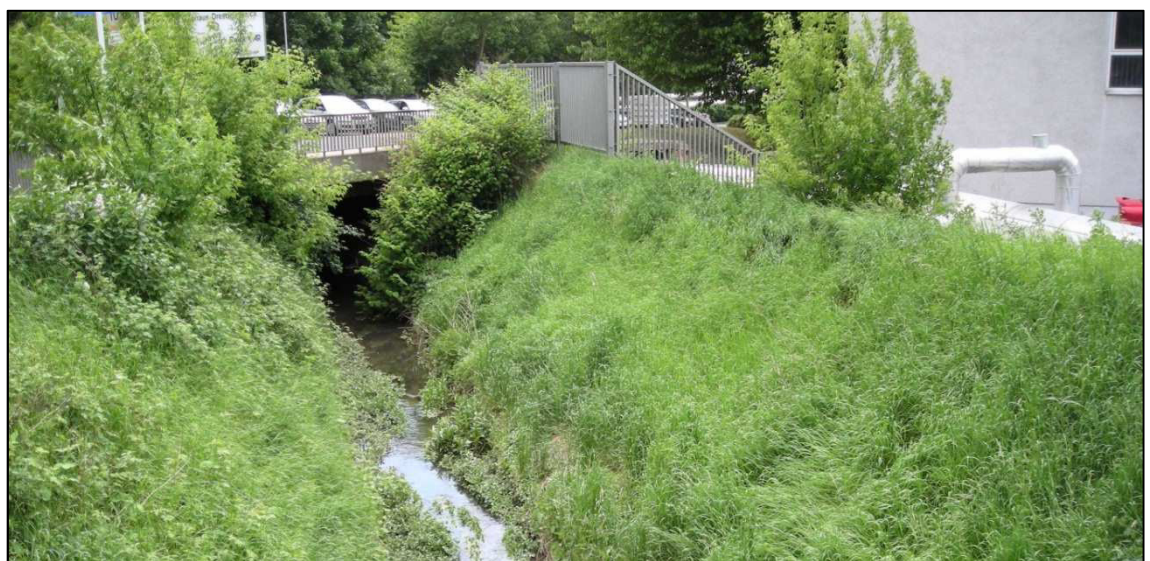
Abbildung 7-26: Deichabschnitt am Fluss-km 3,535 mit Blick auf die Zufahrt Autohaus Reick (Blick flussaufwärts)
